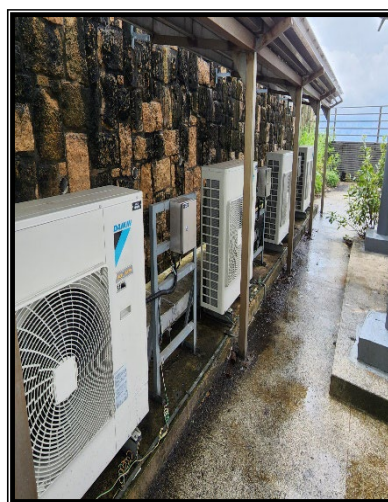
交椅洲無線電發射站空氣調節機組
