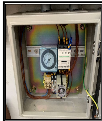
新裝設的機械式定時器 及多段式限時繼電器
