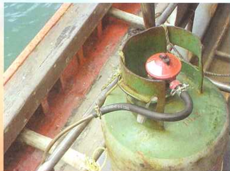
採用金屬喉管接駁氣罐和用具
