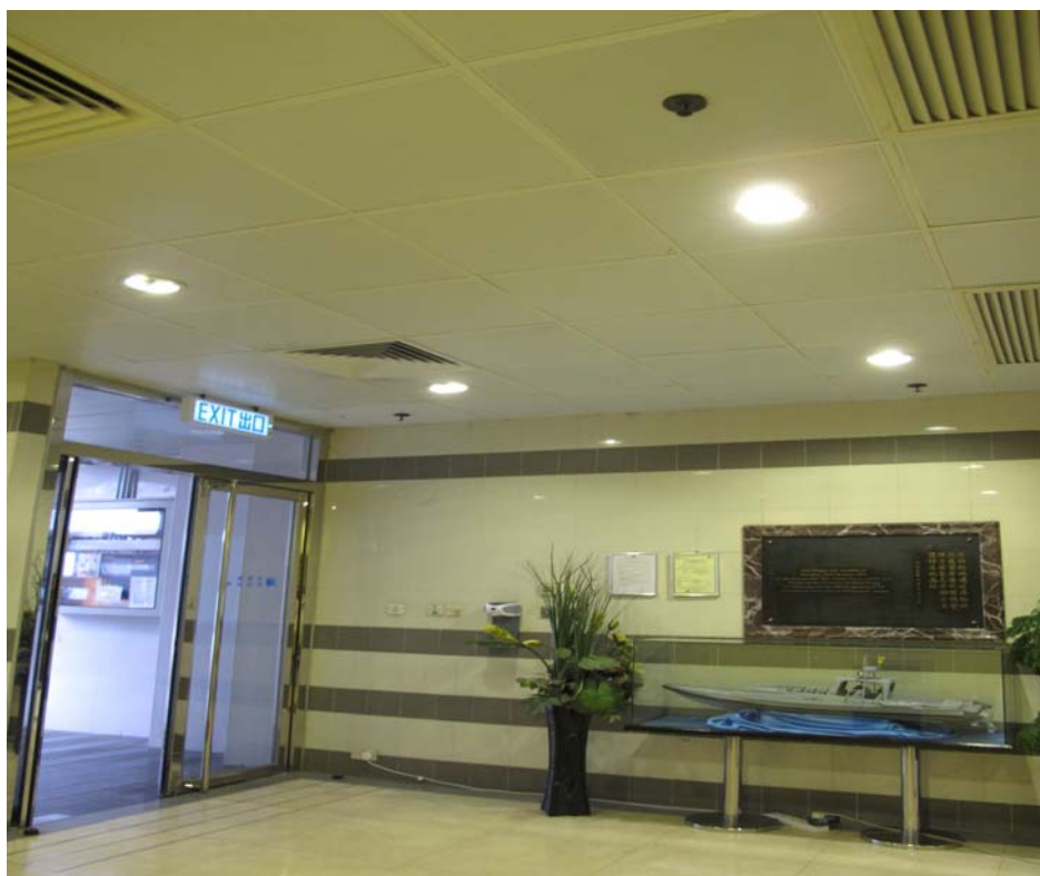
政府船坞行政大楼的发光二极管照明灯
