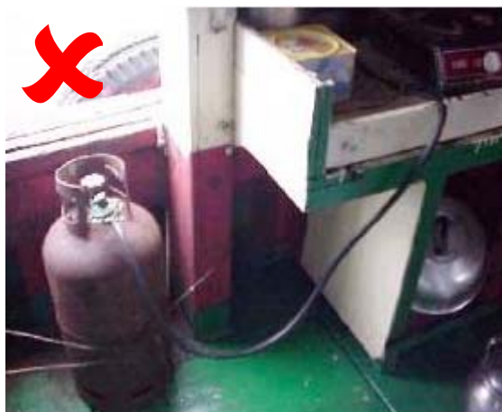
石油氣爐及瓶須固定裝置， 橡膠喉管勿超過 1 米
