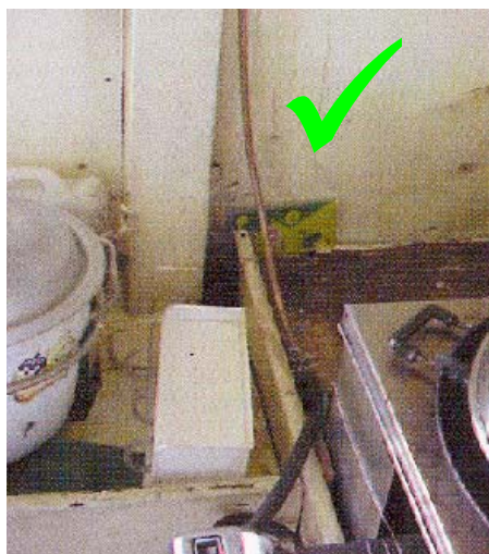
使用金屬喉管接駁氣罐和爐具
